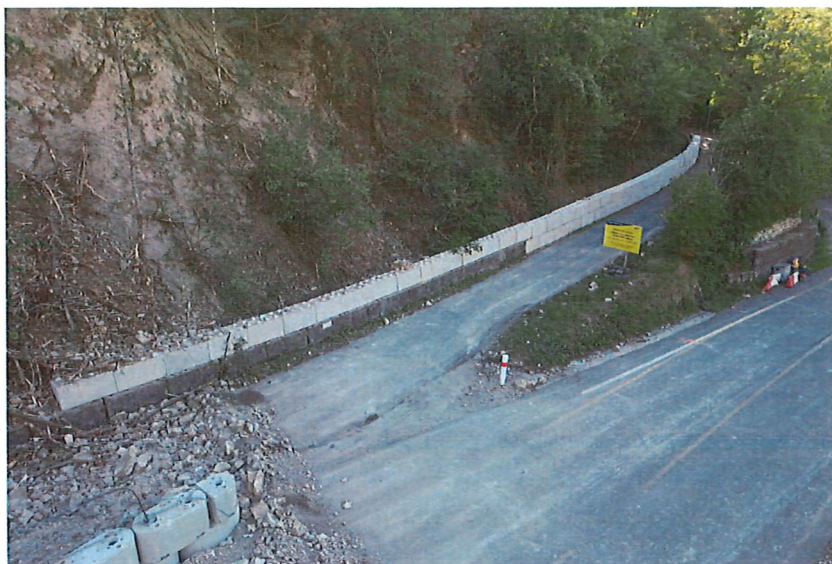
Matériaux purgés et impacts sur le mur de protection
