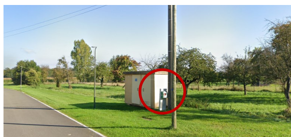
Rue du Foin sur la façade de l'armoire électrique
