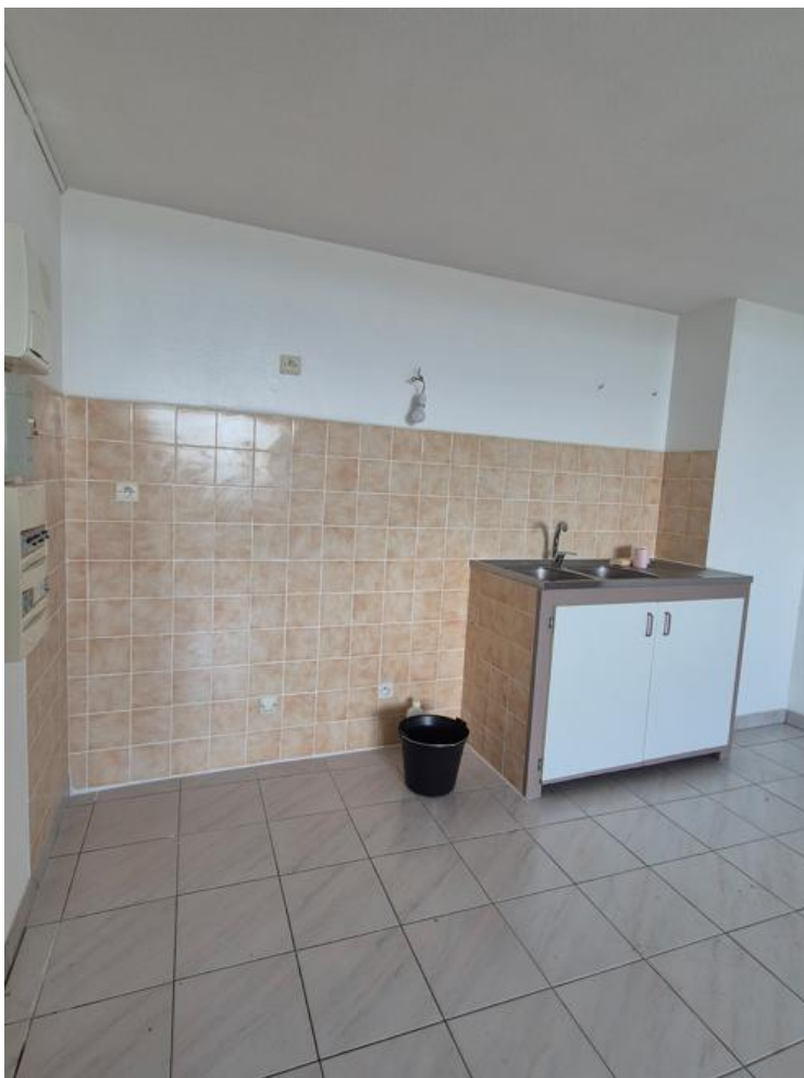
Sanitaire, cuisine et wc
