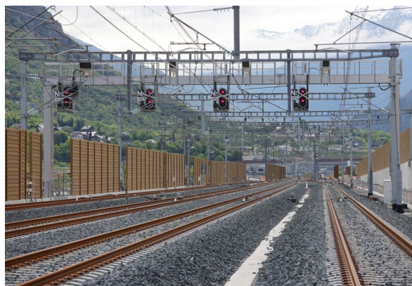
La nouvelle signalisation, en cours d'essais
