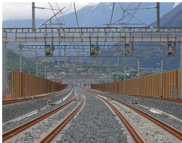
Les nouvelles caténaires le long de la plateforme
